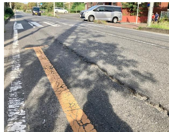
(劣化が著しい現地道路の画像)
