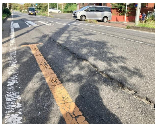
（劣化が著しい現地道路の画像）
